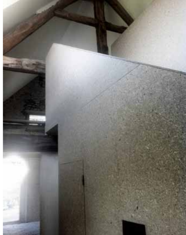
Détail de menuiserie bois sur l'embrasure en béton Saint Étienne sous Bailleur (27)
