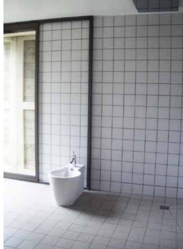
La douche de la salle d'eau Coupigny (27)
